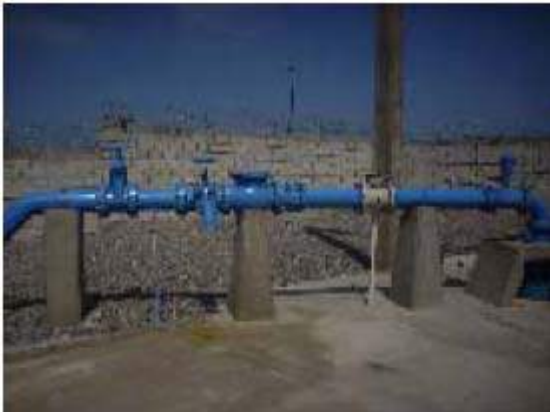
Pozo Profundo de Alimentación
